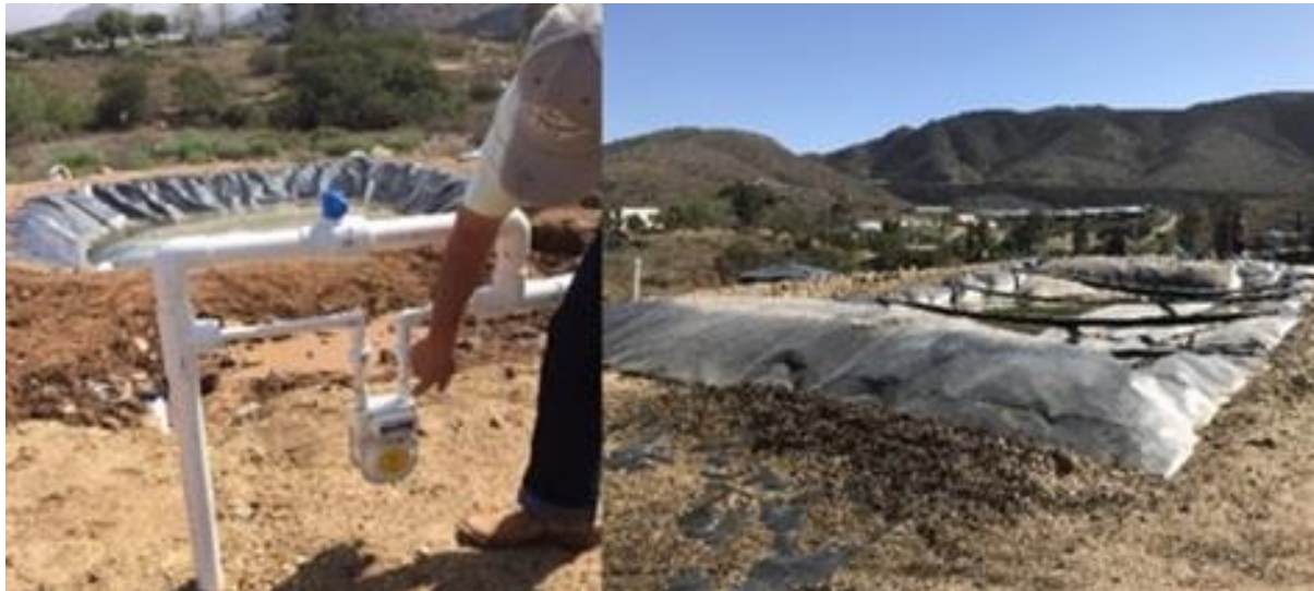
Figura 5, Puesta en marcha del digestor.
